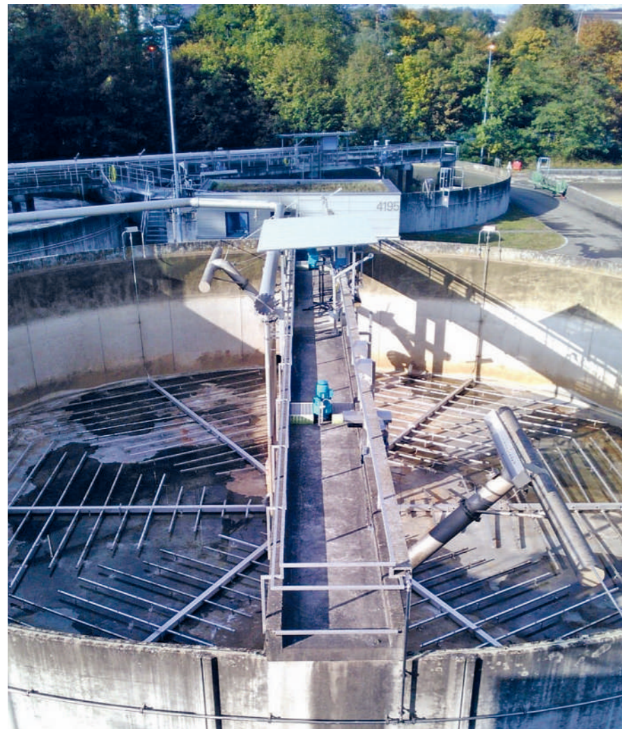
Erweiterte Belüfterstränge im SBR.
